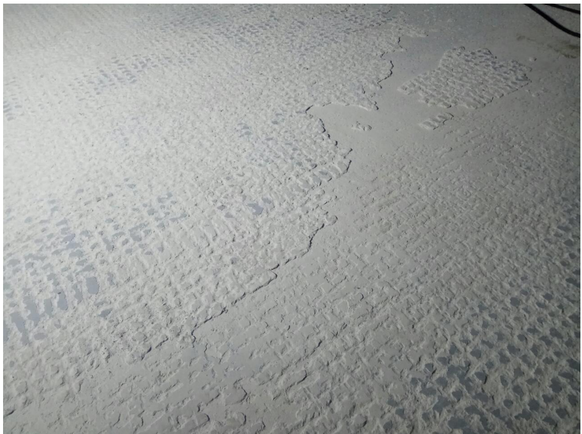
Фото .2.2. Локальные разрушения ровнителя. Тонкий слой ровнителя 3 -5 мм
