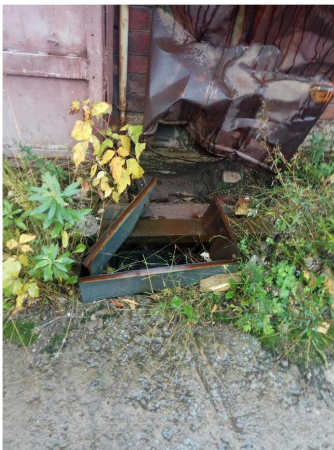
Фото .2.8. Отсутствие отмостки
