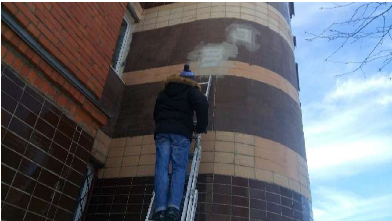
Фото.1. Освидетельствование ограждающей конструкции квартиры №15
