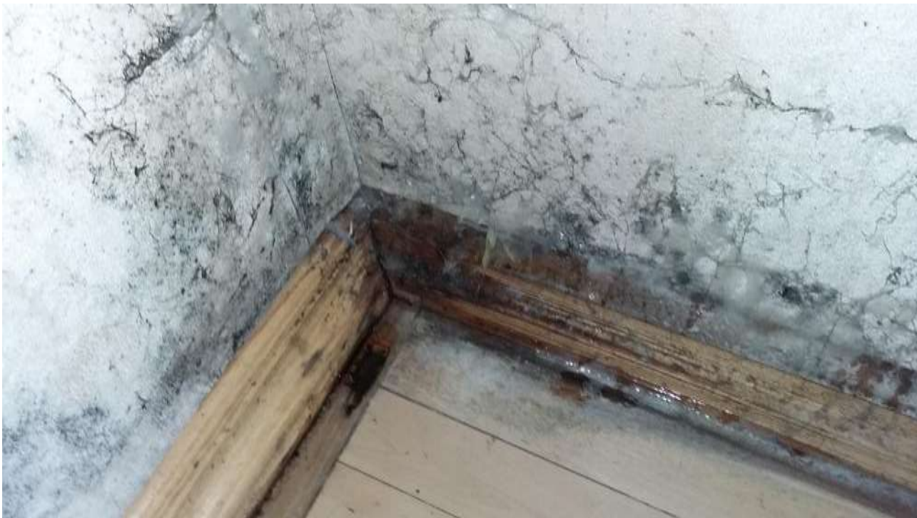
Фото.9. Образование наледи, увлажнение стены, образование плесневого грибка в углу комнаты 13 м 2 . Дата съемки 19.03.2016 г.
