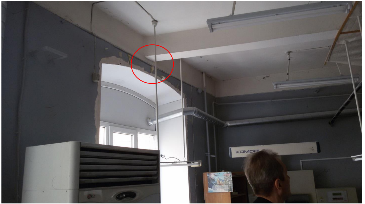
Фото П.3.11. Ослабленное сечение стены в месте опирания балки БЗ
