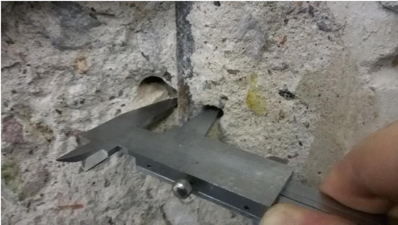
Фото П.3.7. Вскрытие армирования колонны
